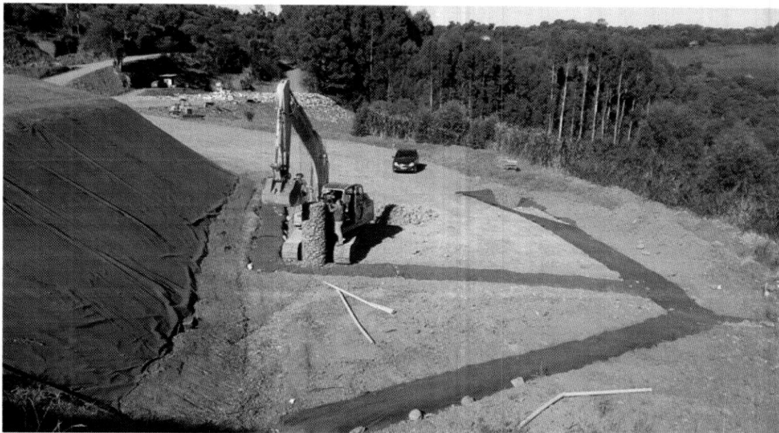
Figura 37 - Sistema de drenagem de chorume e gás
